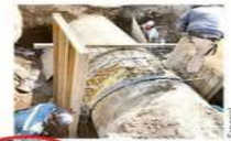
Al reparar una fuga de agua, las autoridades ubicaron una manguera de una toma hechiza.
